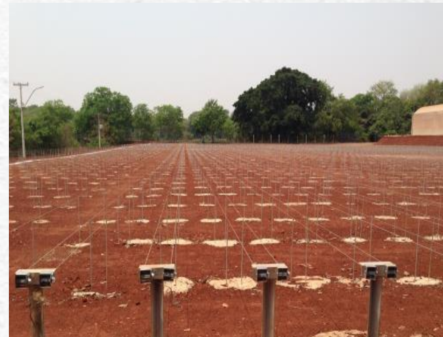
Bancadas de Terminação
